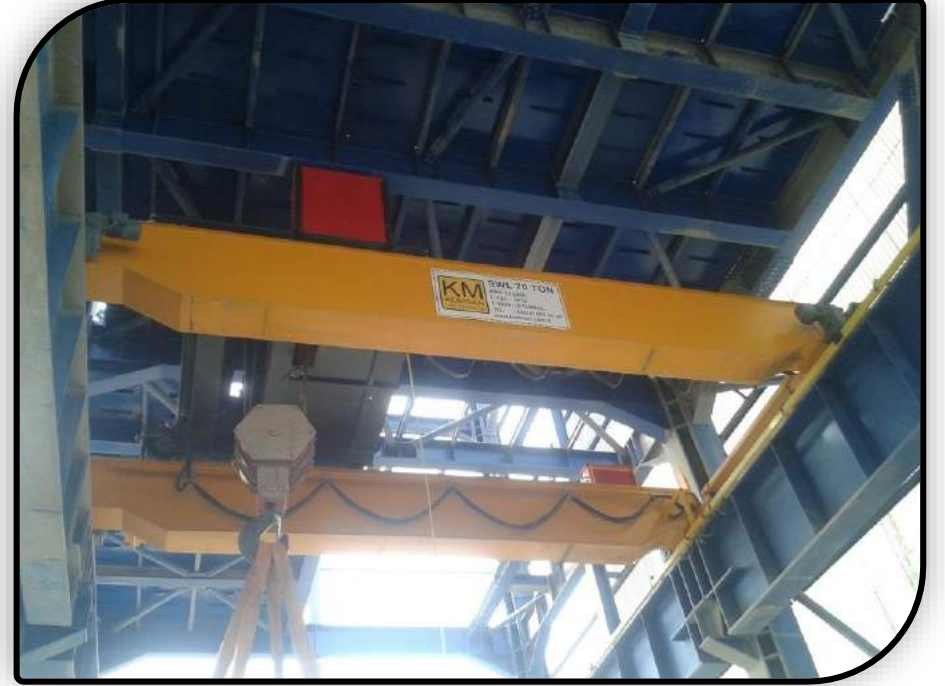
70 Ton Kapasiteli Çift Kirişli Gezer Köprülü Vinç
