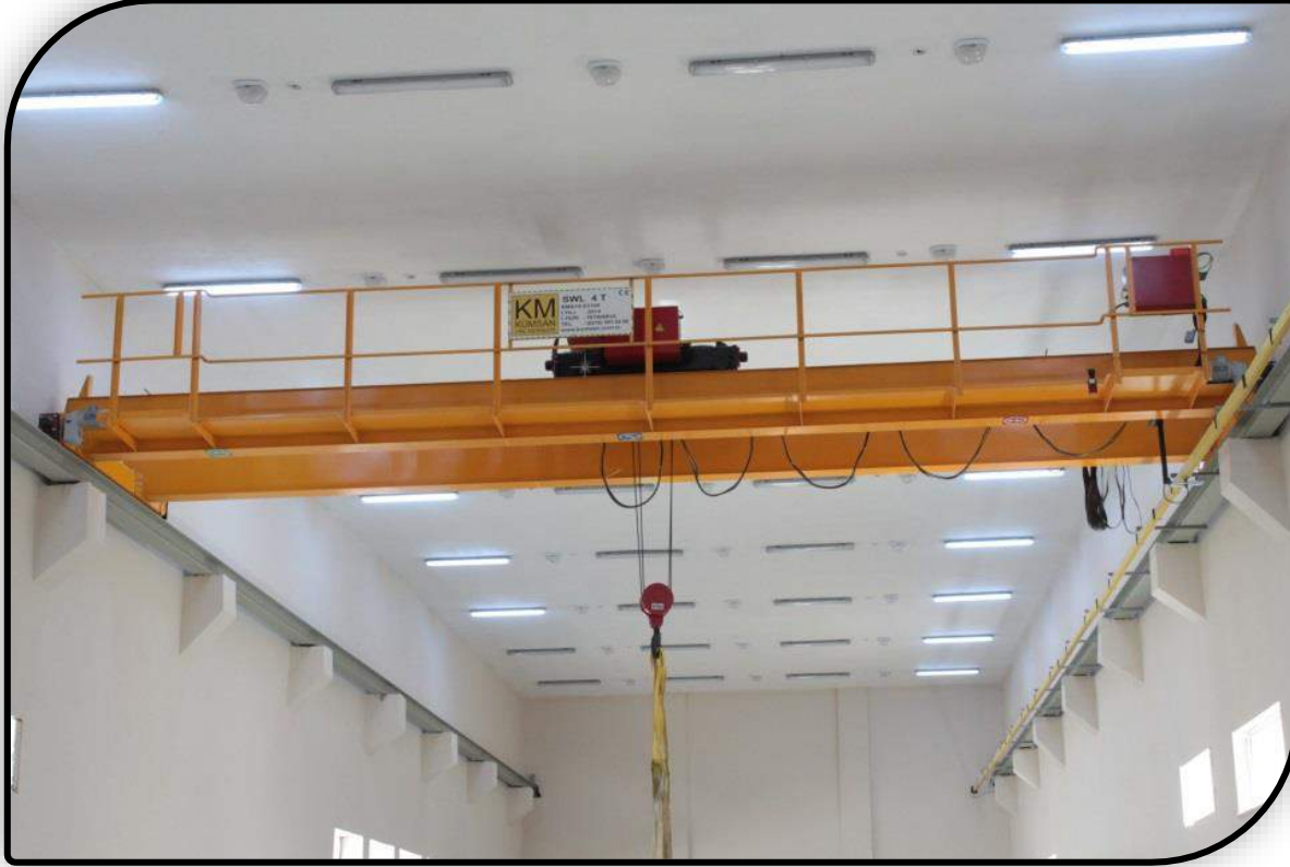
4 Ton Kapasiteli Çift Kirişli Gezer Köprülü Vinç
