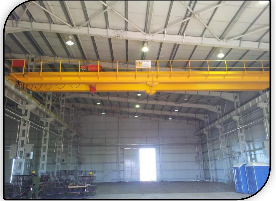
5 Ton Kapasiteli Çift Kirişli Gezer Köprülü Vinç
