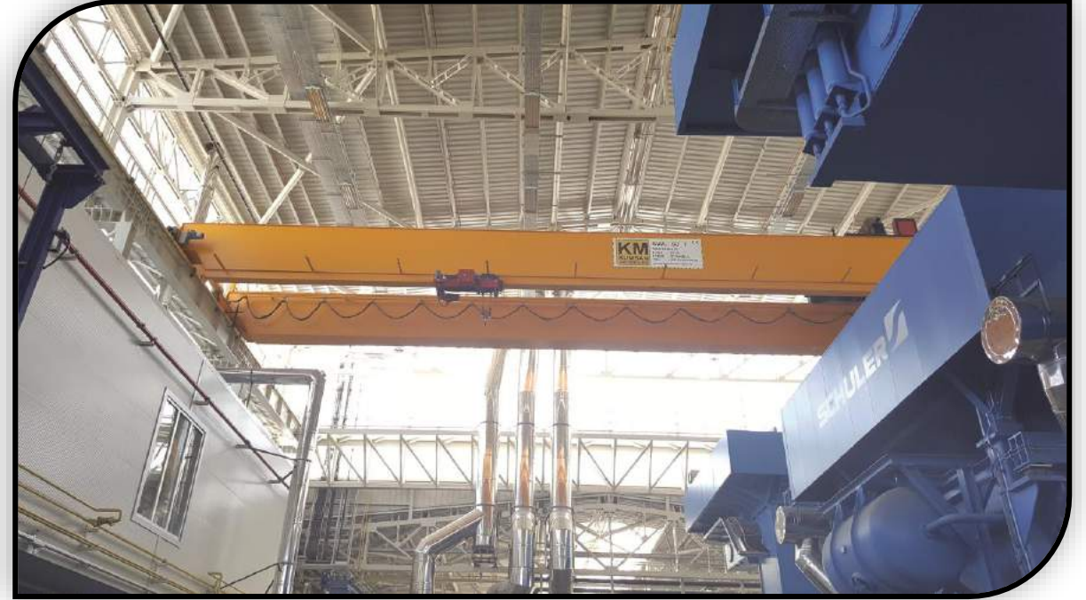
50+5 Ton Kapasiteli Çift Kirişli Gezer Köprülü Vinç
