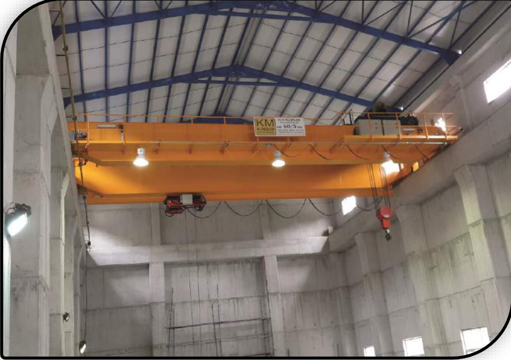
60 / 5 Ton Kapasiteli Çift Kirişli Gezer Köprülü Vinç
