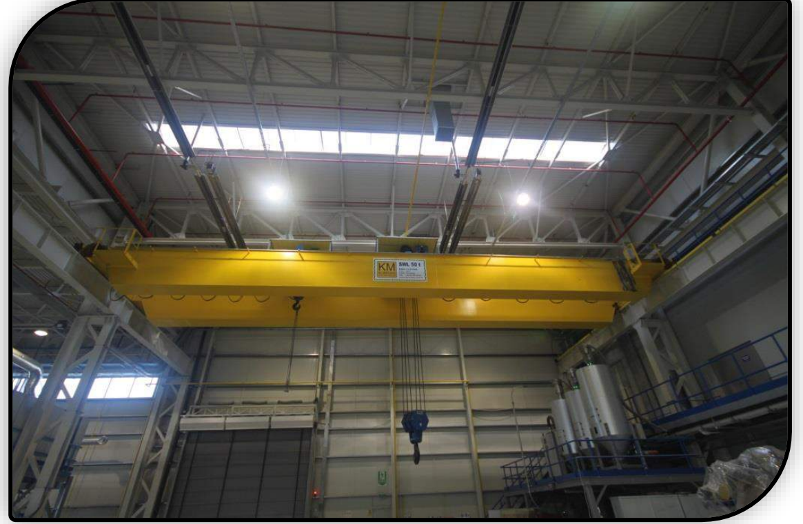
50 Ton Kapasiteli Çift Kirişli Gezer Köprülü Vinç
