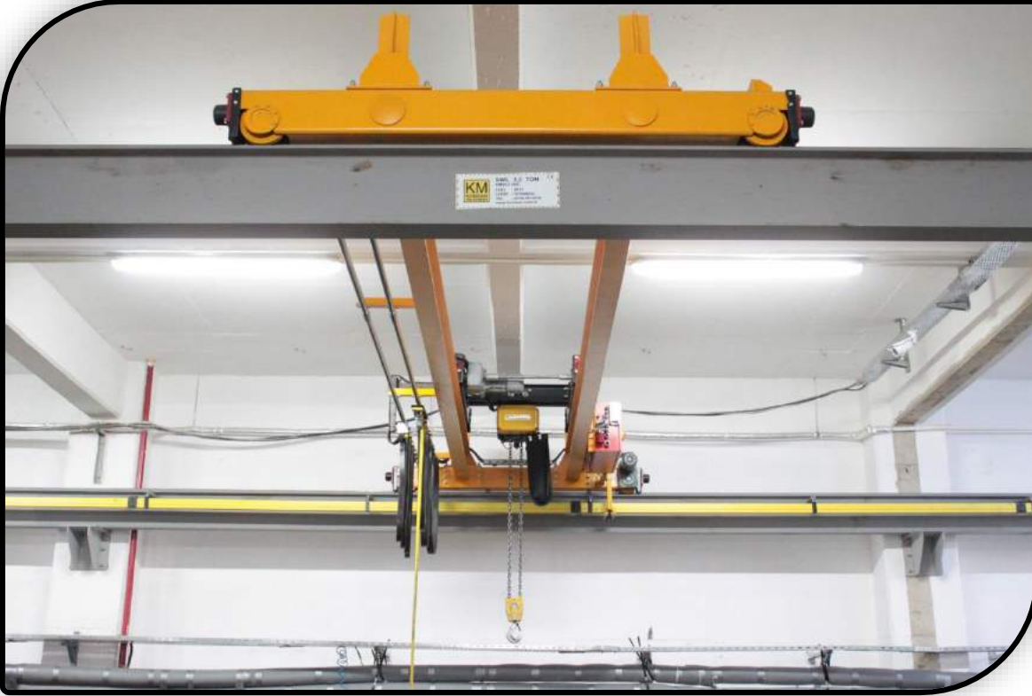
3,2 Ton Kapasiteli Çift Kirişli Gezer Köprülü Vinç
